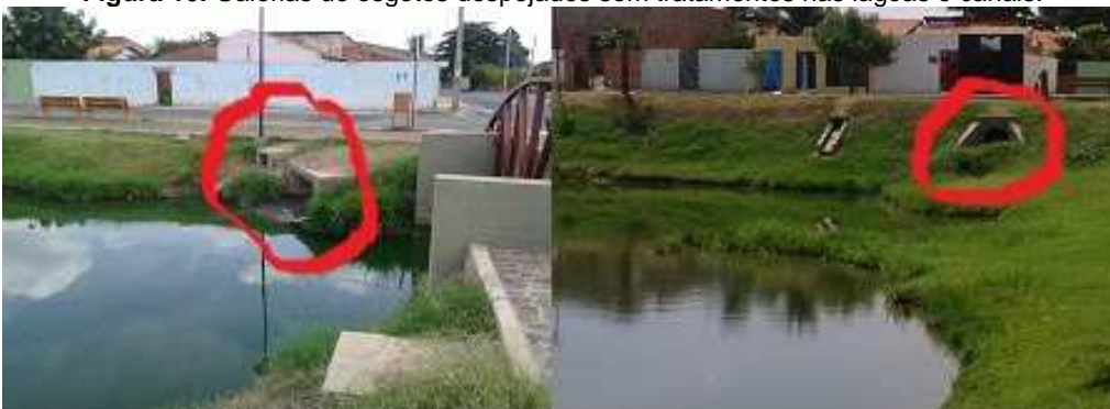
Figura 10. Galerias de esgotos despejados sem tratamentos nas lagoas e canais.
